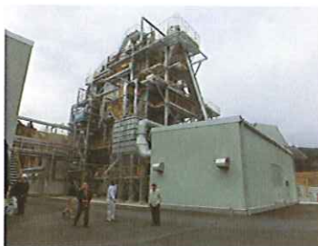
バイオマス発電所
