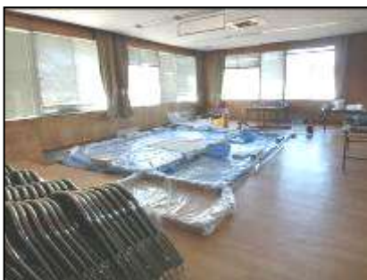
大会議室雨漏り処置
